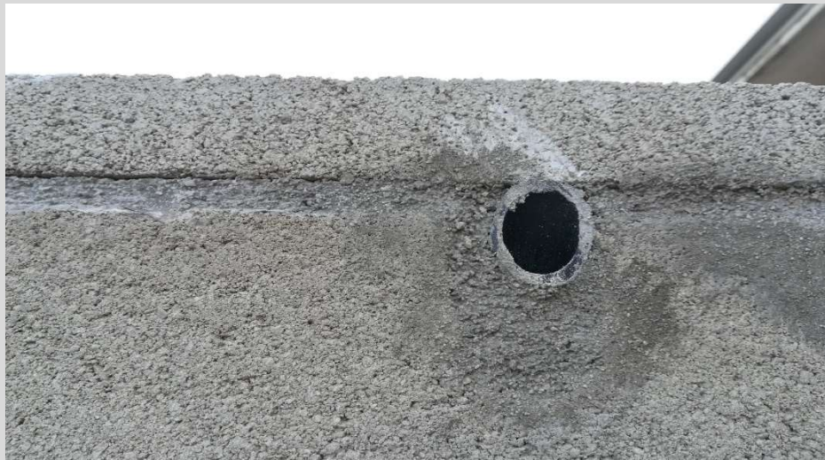
Ilustración 4. Tubo para aspiración de aire nuevo
